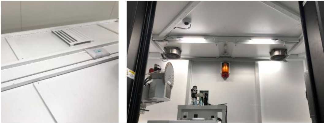
工业 CT 机铅房内顶部轴流风机
