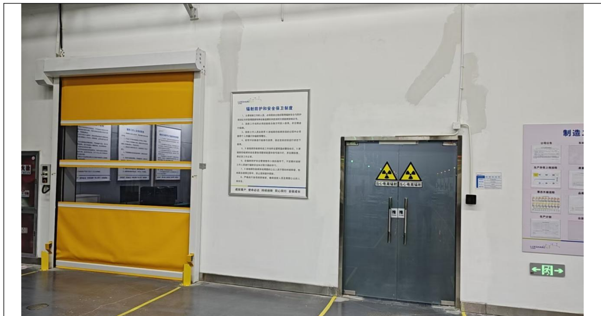
工业 CT 机所在工夹具房的出入口
